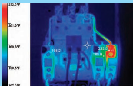
Las conexiones de la bomba de este evaporador muestran una temperatura 50 grados mayor que en la fase C.
