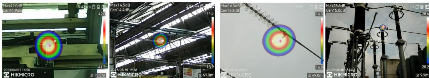
Detección de fugas de gas
